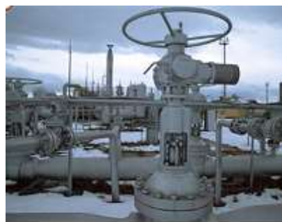
Магистральный газопровод «Комсомольск-на-Амуре – Хабаровск»
