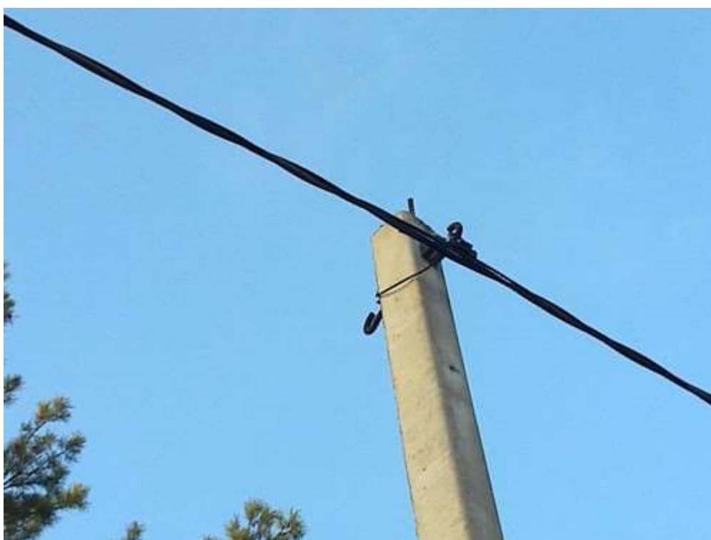
Рисунок. Крепление самонесущего изолированного провода на опоре ВЛ Рассмотрим подробнее крепление проводов к штыревым изоляторам. Крепление проводов к штыревым изоляторам обычно выполняют проволочной вязкой. Также для крепления могут применяться антивибрационные зажимы и плашечные зажимы типа ПА. Самонесущие изолированные провода на ВЛ напряжением 10 кВ (их еще называют защищенными) крепят к штыревым изоляторам спиральными вязками, изготовленными из оцинкованной пружинной проволоки с
